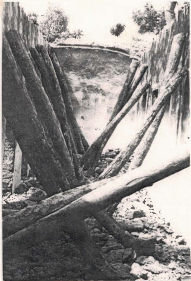
Suite à l'incendie en janvier 1992, enlèvement des poutres en doum du bureau existant avant remplacement des toitures avec des voûtes et coupoles.
