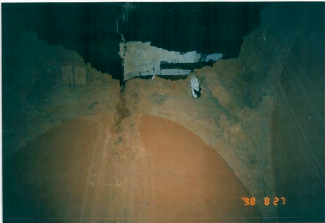
voûte d'arrêtes effondrée dans le restaurant du centre artisanal de Tahoua
