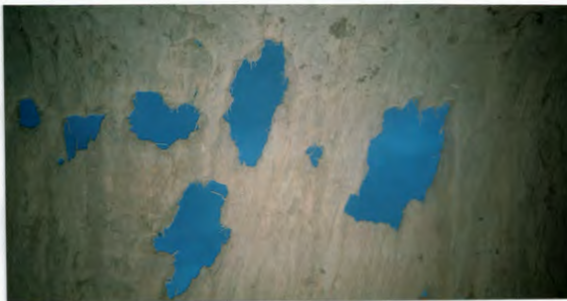
La pluie a fini par creuser des trous dans la toiture d'un des 2 bâtiments de démonstration (1983) mais elle ne s'est toujours pas effondrée. Le bâtiment n'a jamais été crépi depuis sa construction.
