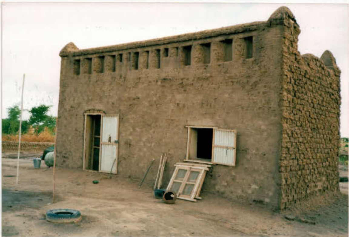
Erosion de loin plus importante de la façade est (à droite), la plus exposée aux intempéries.
